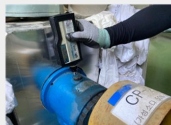
펌프 진동 측정 (펌프 상태 확인)
